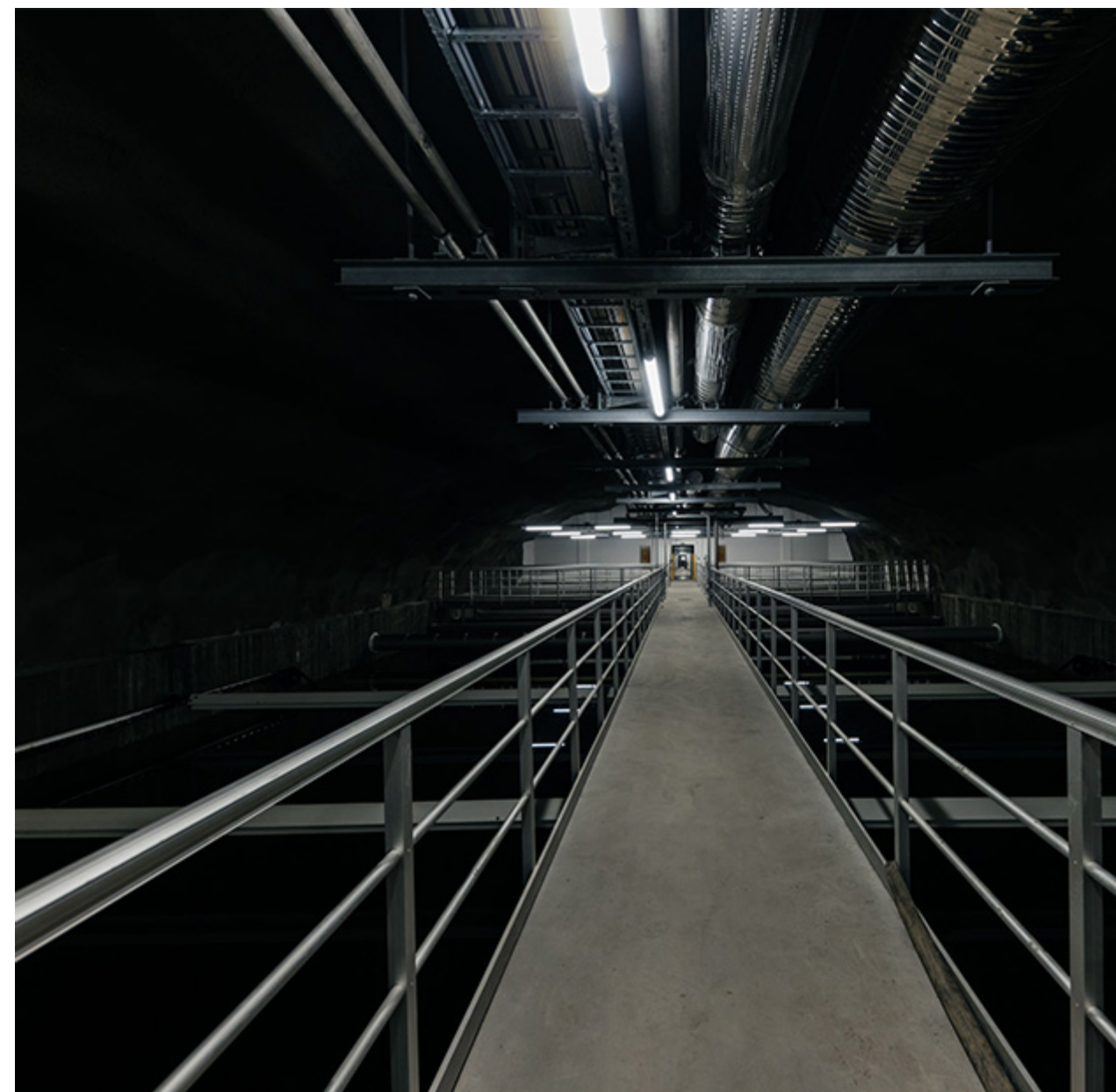
Blominmäen jätevedenpuhdistamo, Espoo
